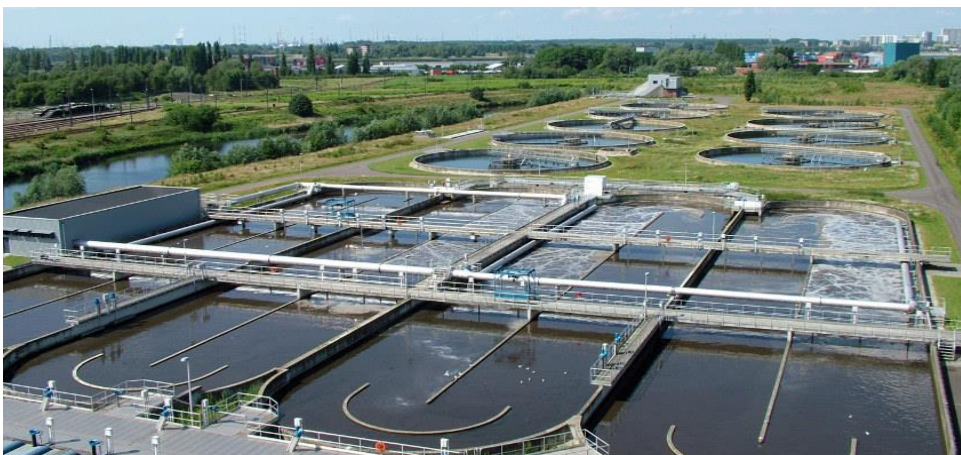
Figure III.1. Station d'épuration des eaux usées ( assainissement collectif ).
